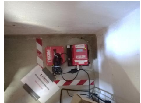
Erschütterungssensoren zur Beweissicherung der umliegenden Bauten
